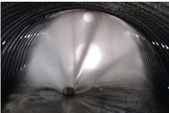
Mit der Kunststoff-Rigole können später auch die für die Versickerungsleistung maßgeblichen Wände und Böden komplett gereinigt werden.
