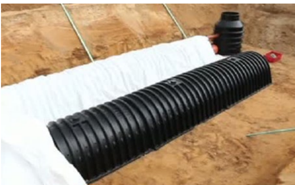
Erster Rigolen-Tunnel in Deutschland mit DIBt®-Zulassung.
